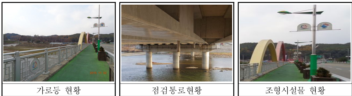
【그림 3.26】 부대시설 설치현황
