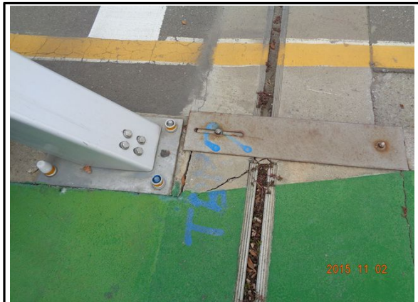
A1 후타재 파손
