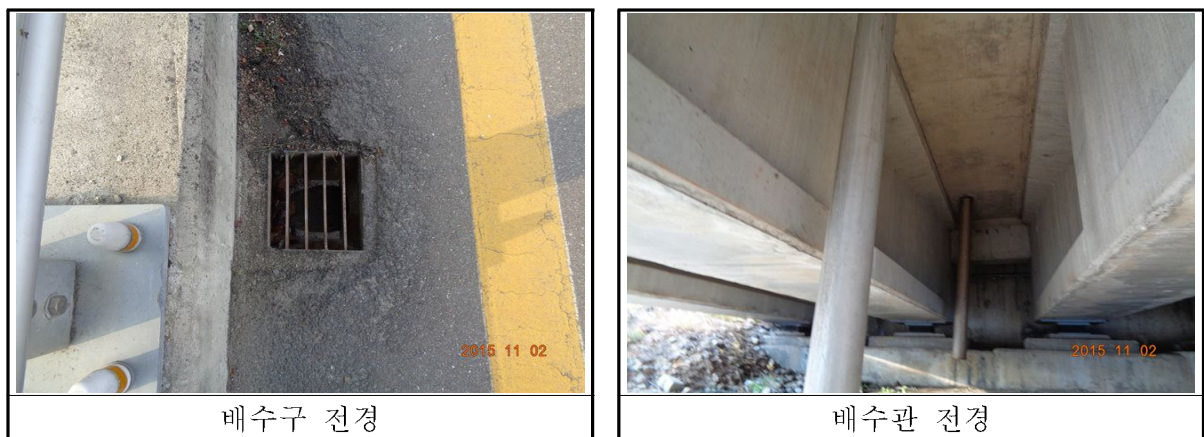
【그림 3.25】 배수시설 손상 현황
