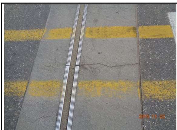
A2 후타재 균열
