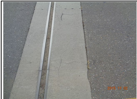
A1 후타재 균열
